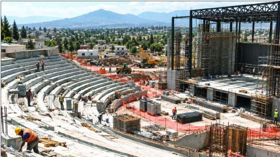
TEATRO AL AIRE LIBRE DE LA ALAMEDA DE TEXCOCO Obra pendiente del paquete estatal de infraestructura.
